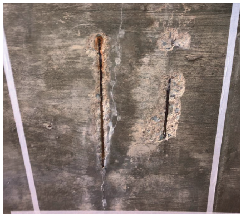
Fissura em laje, perda do cobrimento da armadura e corrosão.
