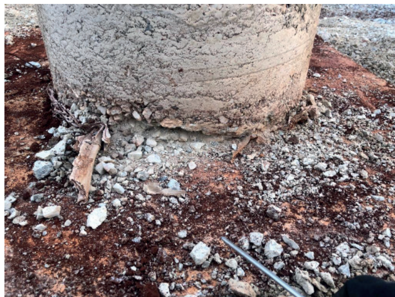
Segregação do concreto em estrutura de estaiamento.
